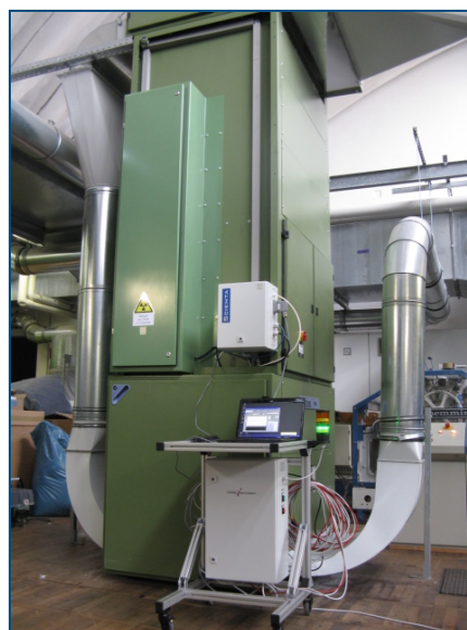
Abb. 1: Am Trützschler BSL-1200 verknüpfte Mess- und Regeltechnik
